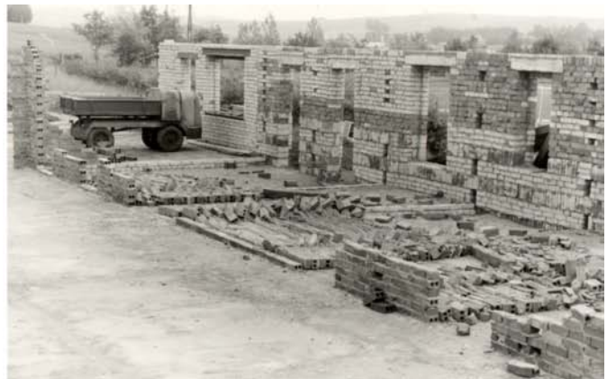
Nicht ohne Probleme ging das Baugeschehen voran. Ein steifer Ostwind riss einmal eine frisch gemauerte 13er Gangwand um, weil die stützenden Querwände noch fehlten.
